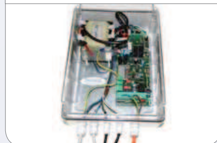
Nuovo quadro comando con display
